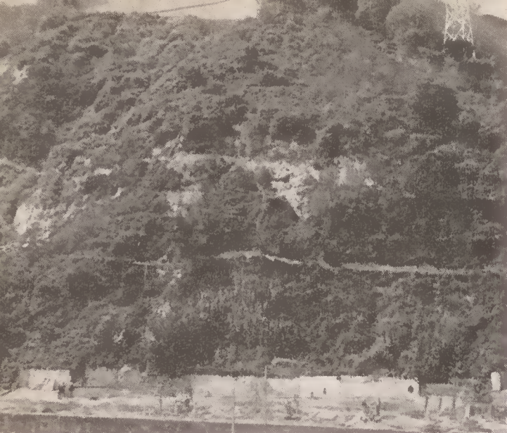
A encosta de maior pendor sobre a linha férrea : Portas do Sol. As obras estão decorrendo de forma a conservar-se a histórica muralha, mantendo-se a configuração da altaneira escarpa. Foram construídos dois muros de suporte a dois níveis diferentes (cotas 14 e 31) para aguentar todo o grandioso maciço
