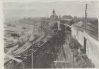
Trabalho de uma linha em construção através das terras desérticas do deserto, para ligar Porto-Elizabet, na costa de Atalândia, a Port-Clarence, onde se encontra uma das mais belas vistas de ferro do globo. O trabalho está em duas localidades de 100 quilômetros, em planície arenosa, limitado por um bel horizonte e varado por impressionantes ventos. Desde há 200 anos que, sob uma temperatura de 30 graus centígrados à sombra, se
