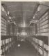
Interior de un túnel de transporte de energía eléctrica en un túnel de 10,5 m.
