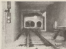
Trilhos para gábia. Este é o túnel construído mediante os métodos construtivos novos estudados.
