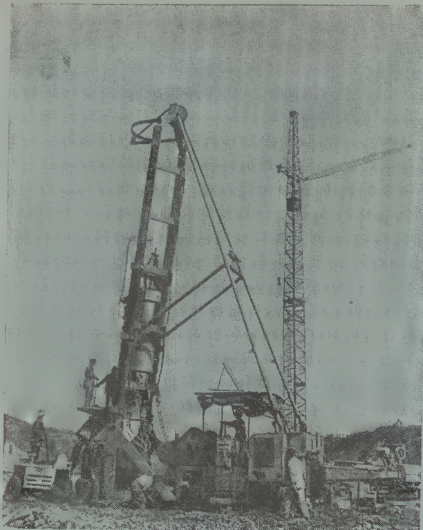
Máquina «BENOTO» executando estacas de 1 m de diâmetro e 60 m de comprimento, nas fundações do viaduto de Sacavém, na auto-estrada do Vale do Tejo
