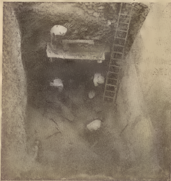
Limpendo a soleira da fundação antes de iniciar a betonagem, pilar P 1 , lado direito.
