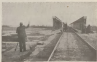
Uma das etapas finais da construção da ponte da Vala da Azambuja, em 1952.
