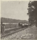
Os trilhos de 15 metros de comprimento, com o corte de 3340 m . No fundo, o muro de contenção construído e o depósito de terra do Ramal de Portimão, e o corte de 3340 m de comprimento de 3340 m e o depósito de terra do Ramal de Portimão.
